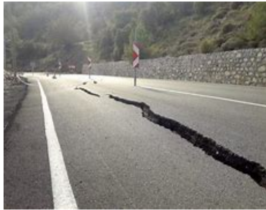
Abbildung 2.41: Risse in einer Straße
