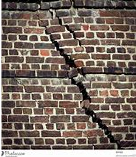
Abbildung 2.39: Ein Riss in einer alten Mauer
